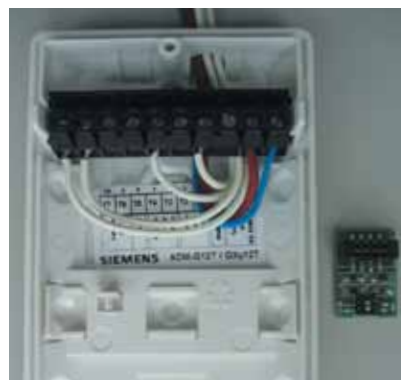
Typická kabeláž detektorů E-line
